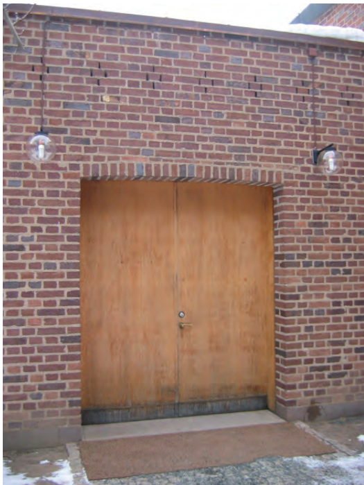
Armaturlarna vid huvudentrén, före åtgärd. Foto: JLM, Jonas Haas januari 2006.
